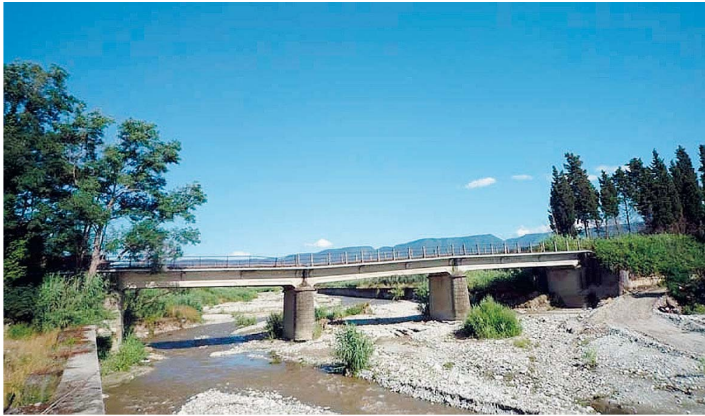
Lo stato attuale del ponte sul Marro reso inagibile dagli eventi alluvionali di dicembre-gennaio
