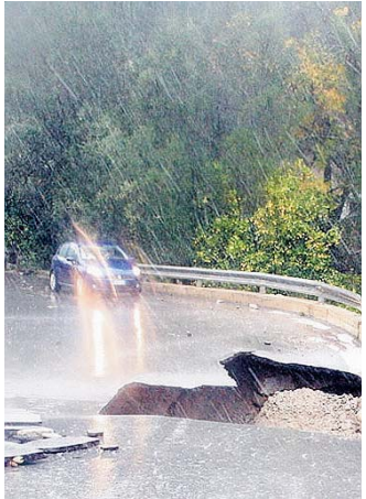
La strada franata in località Ferrandina
